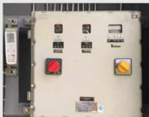
防爆配电及控制系统
