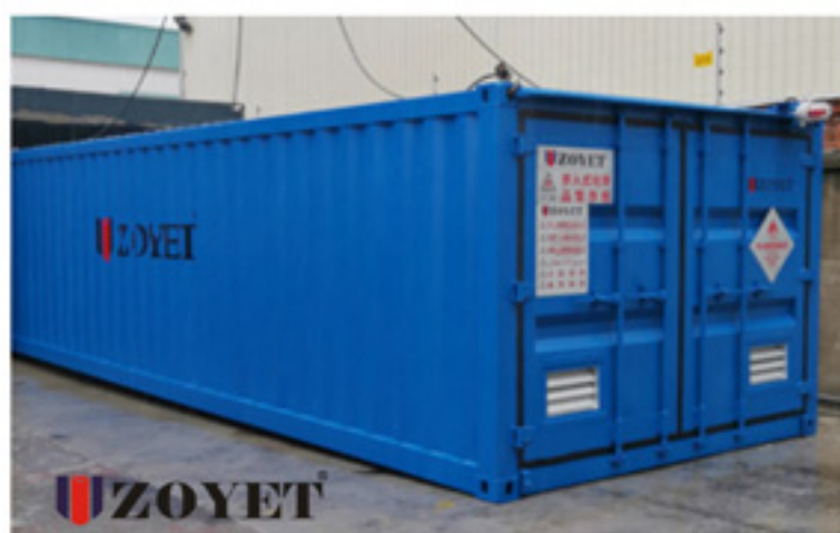
丰安电气项目
